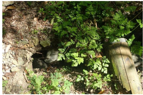
橋に穴が空いている…そろそろヤバイ？
